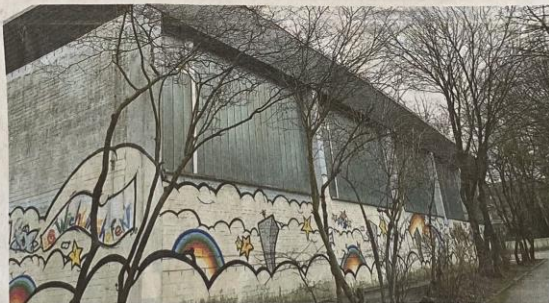
Auch die Turnhalle wird Geschichte sein. An ihrer Stelle wird eine moderne Halle mit Extra-Übungsräumen entstehen.
